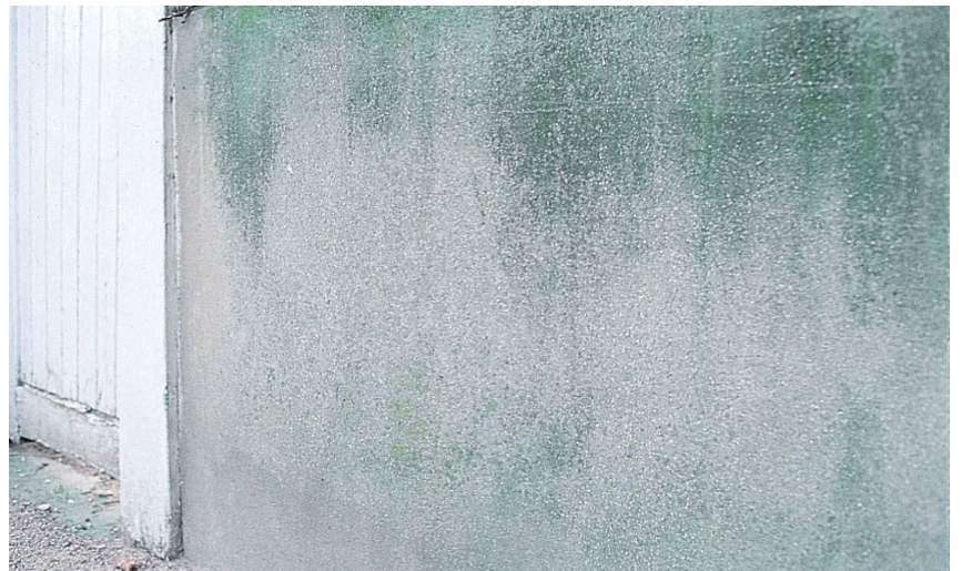
Mousses sur une façade :
